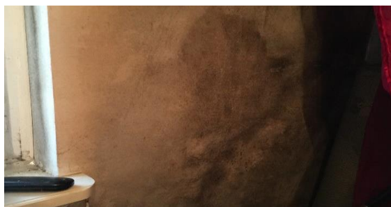
Плесень на наружной стене изнутри
